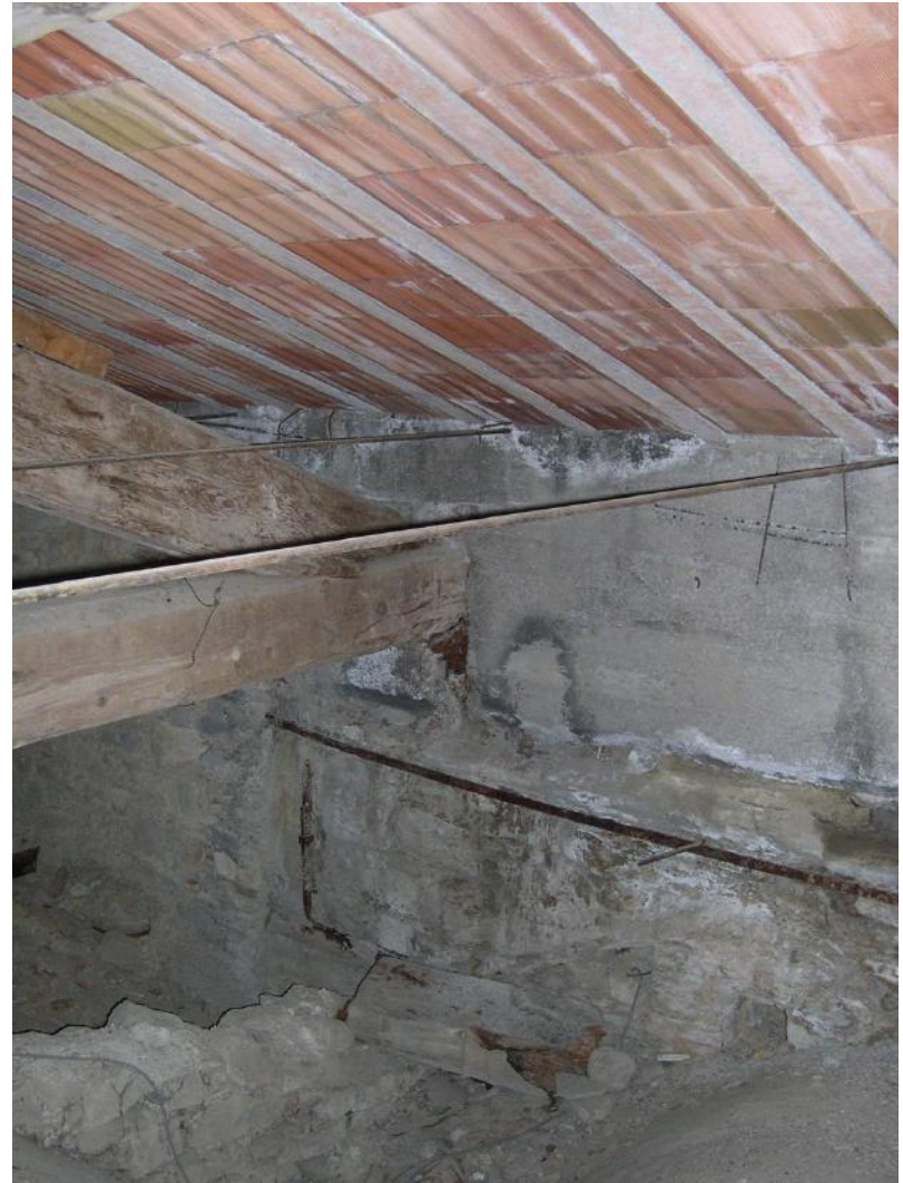
Danno D4/D5- appoggio al limite del crollo per rottura della mensola
