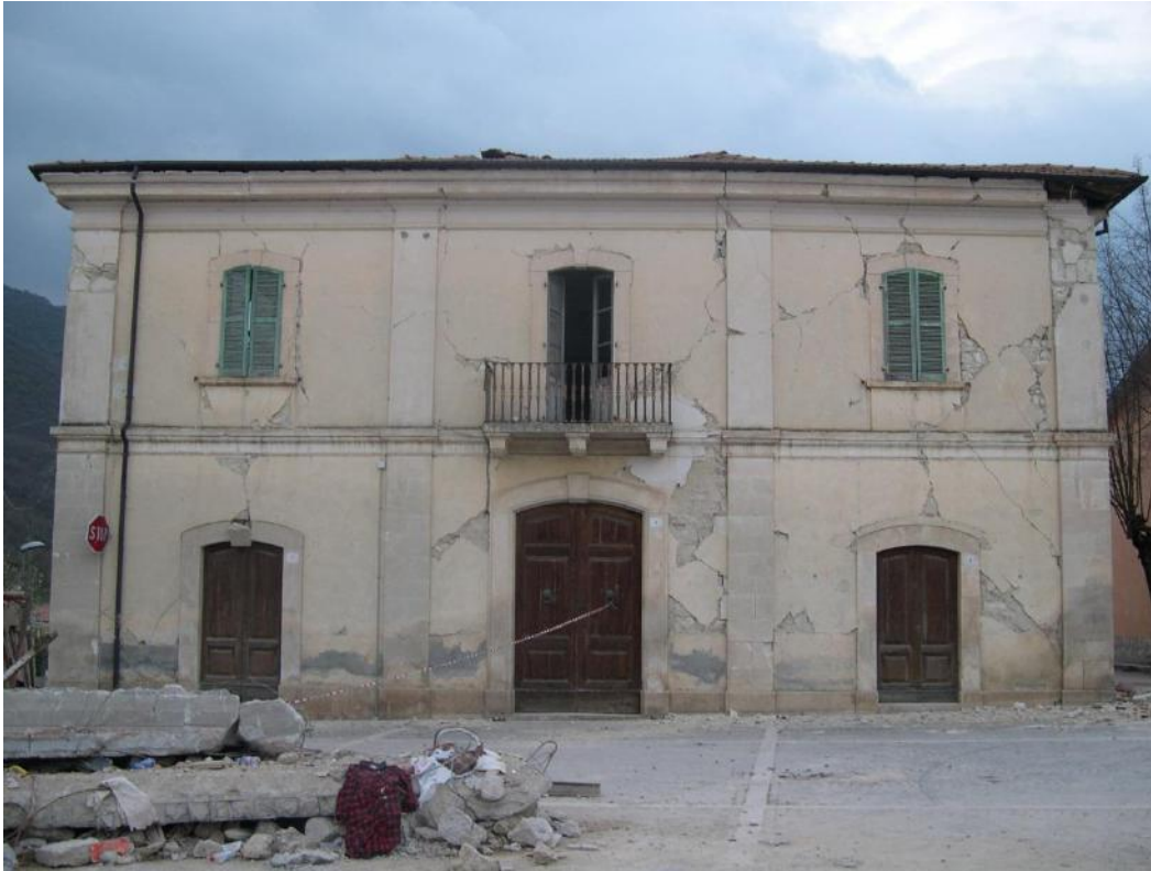
Danno D4 –esteso danneggiamento a taglio che interessa la totalità del paramento murario
