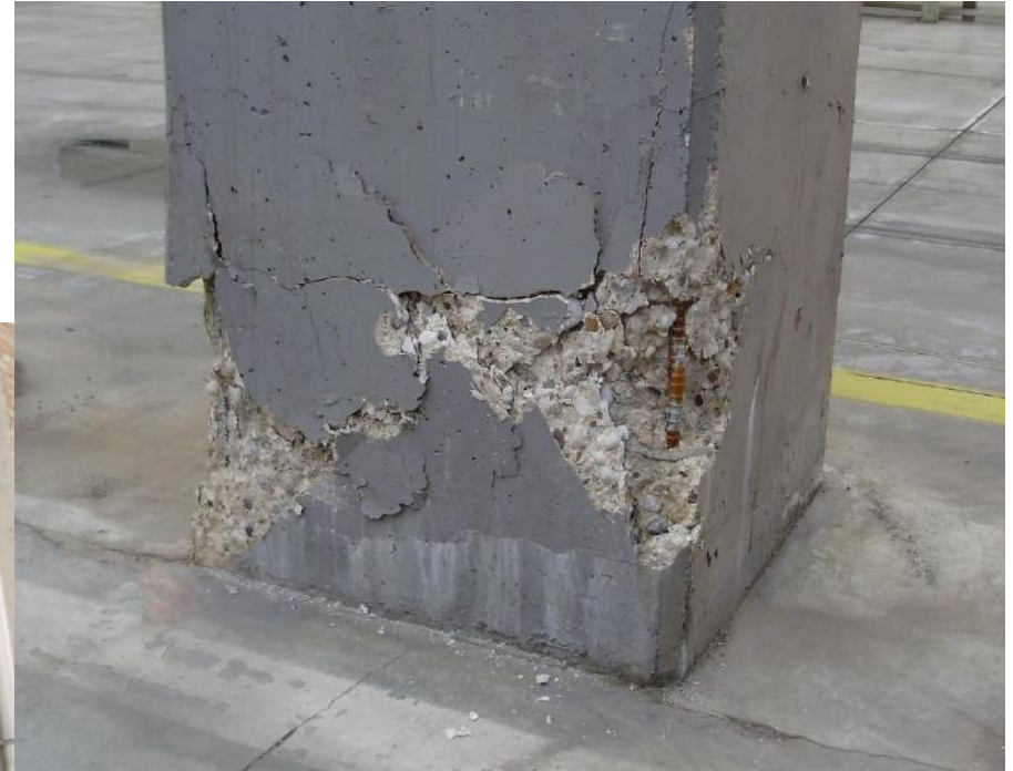
Danno D4/D5 - pilastro in c.a.
