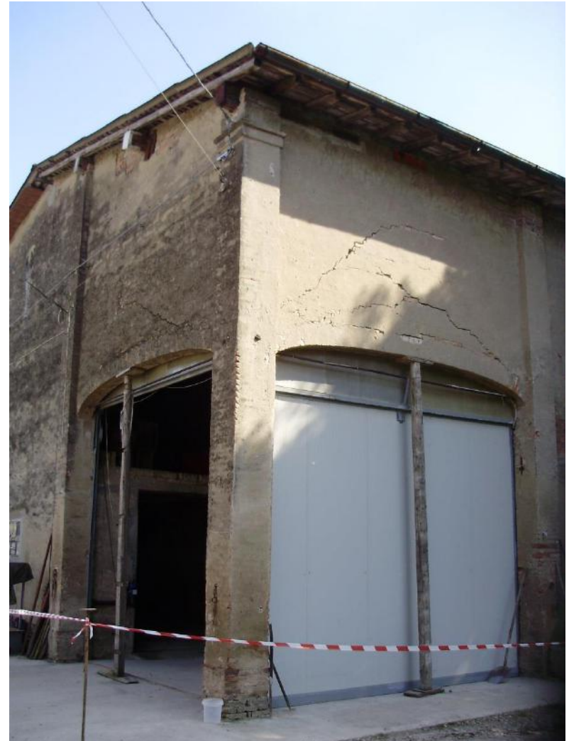
Danno D3/D4-fessurazioni per cedimento archi
