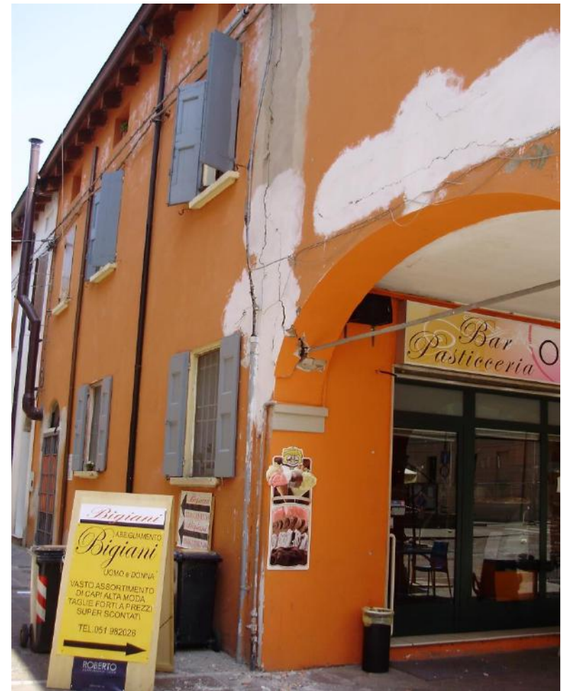
Danno D2/D3-lesione verticale su muratura presumibilmente non ammortata. La maggior gravità del danno è data dal danneggiamento all'ancoraggio della catena
