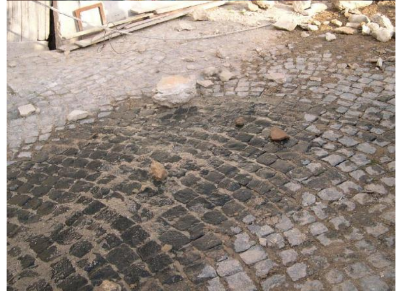
Danno alla rete idrica
