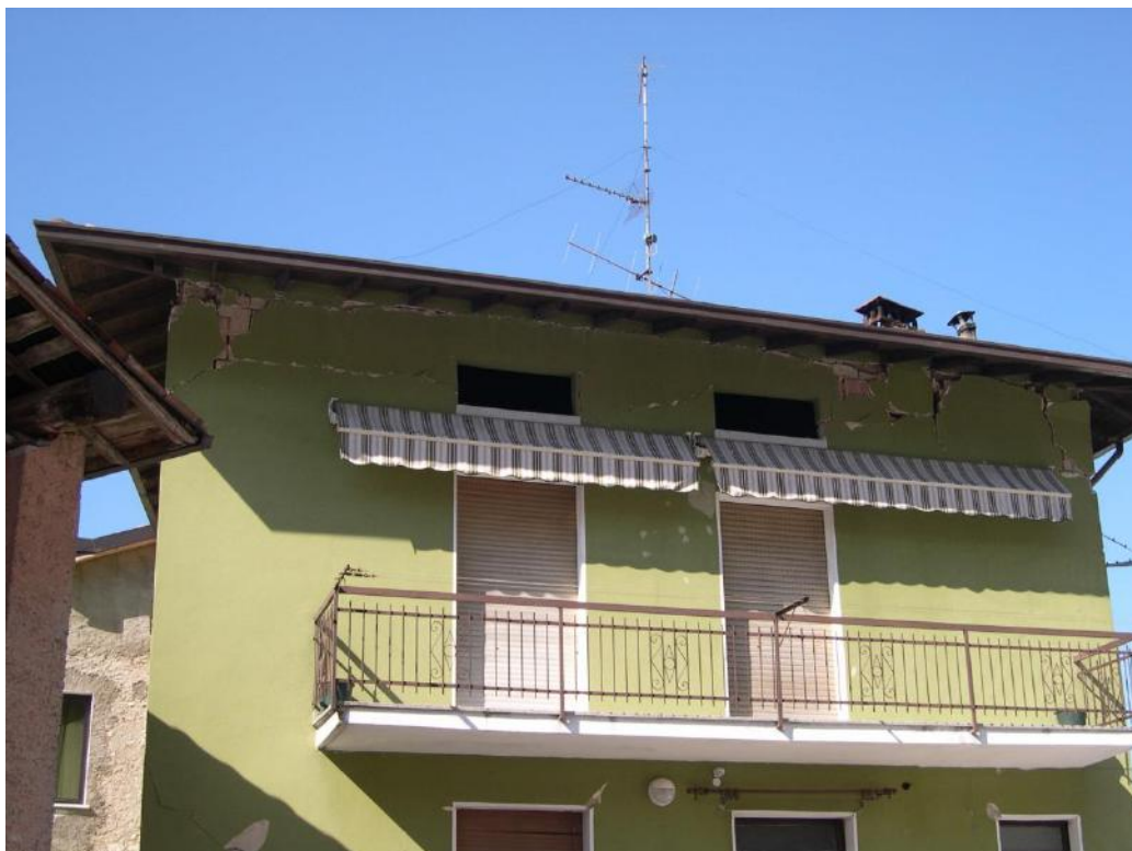
Danno D4/D5 localizzato nel sottotetto–esteso danneggiamento della muratura
