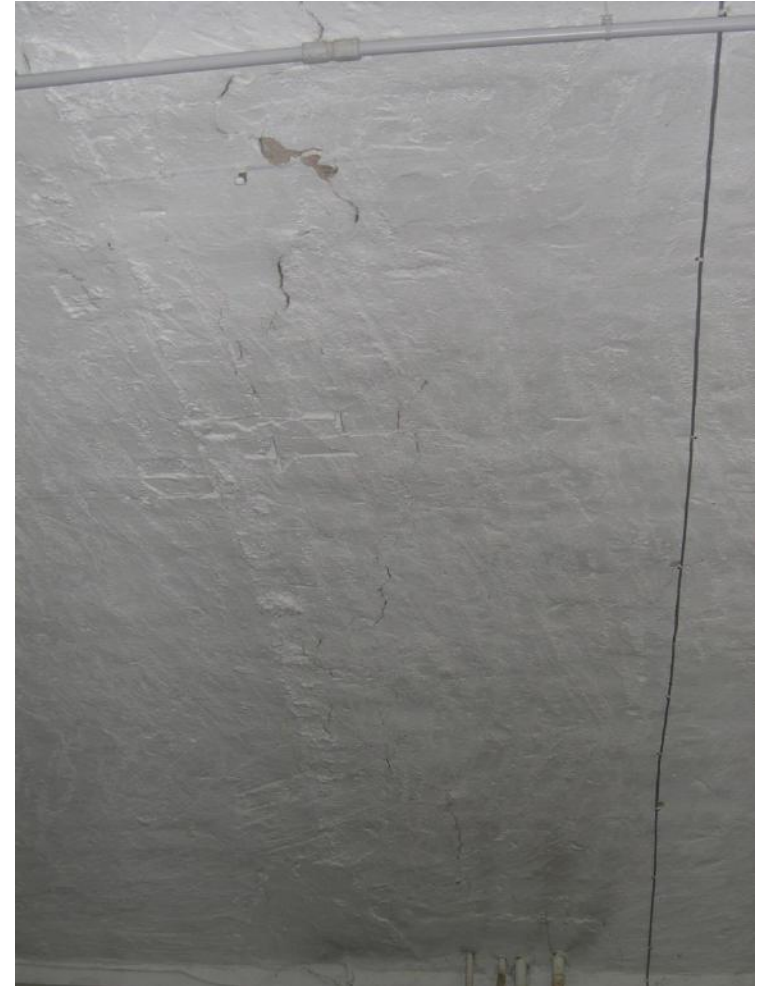
Danno D1-lesione ortogonale alla generatrice della volta
