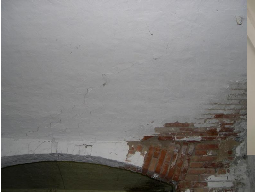
Danno D2/D3-lesione diagonale su volta in muratura ed in chiave all'arco
