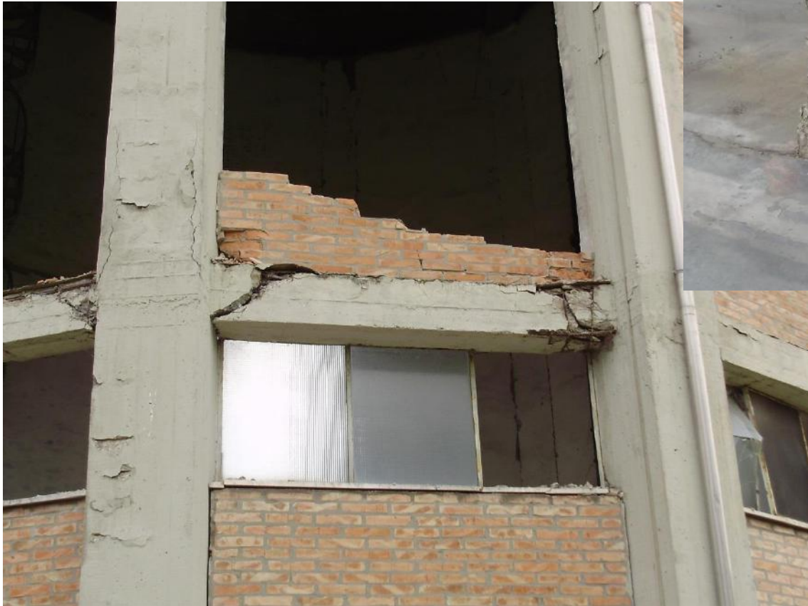
Danno D3/D4-telaio in c.a.
