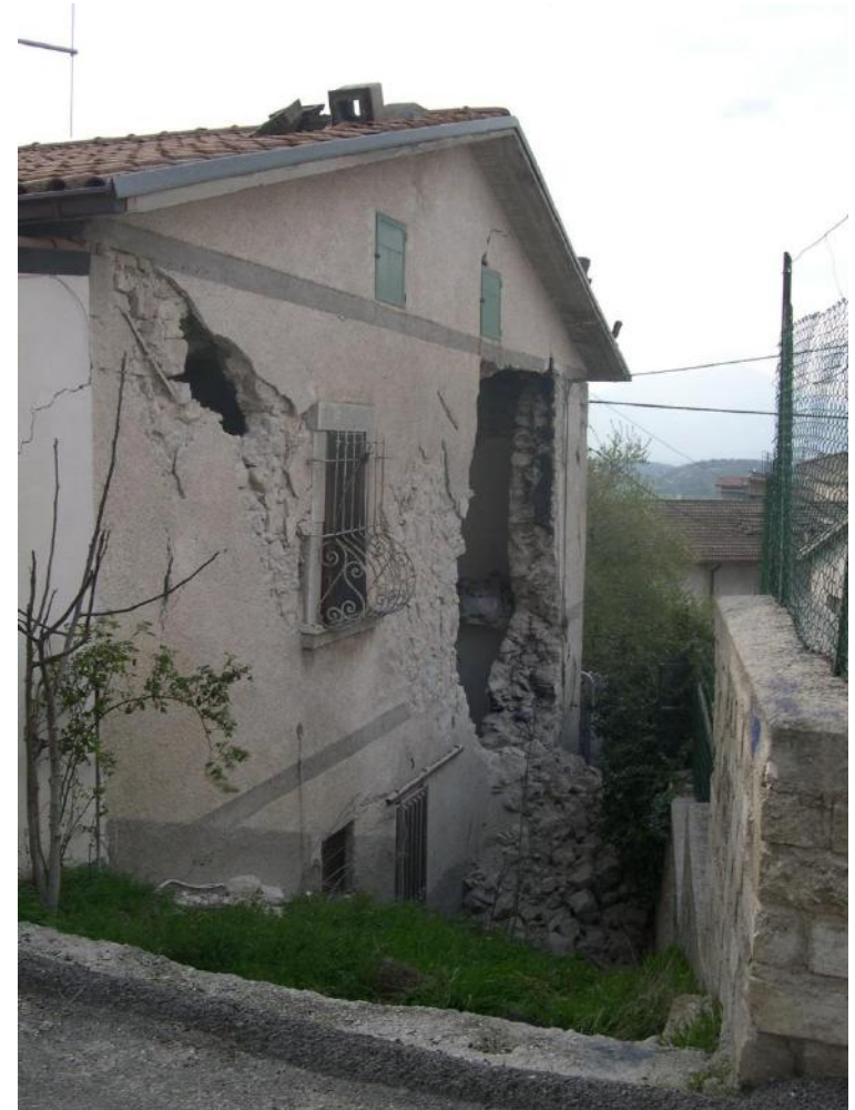
Danno D4/D5- fessurazioni a taglio con crolli parziali per disgregazione
