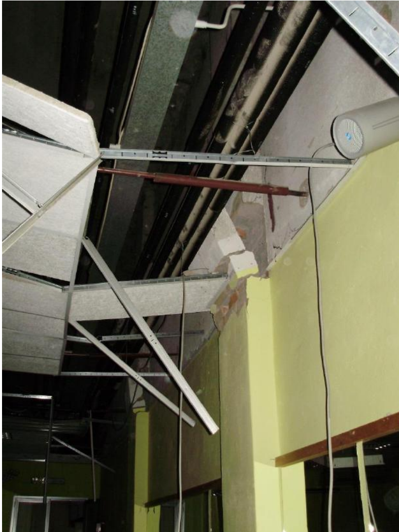
Distacco rivestimenti e controsoffitti
