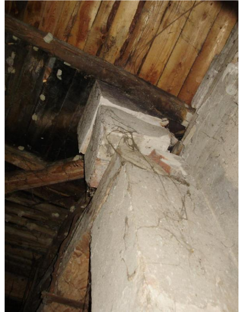
Danno D4/D5- disgregazione di un pilastro in muratura che sostiene un cantonale della copertura
