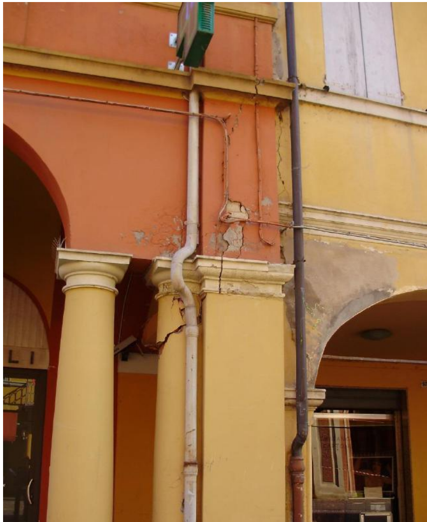
Danno D3-lesione diagonale su struttura in muratura
