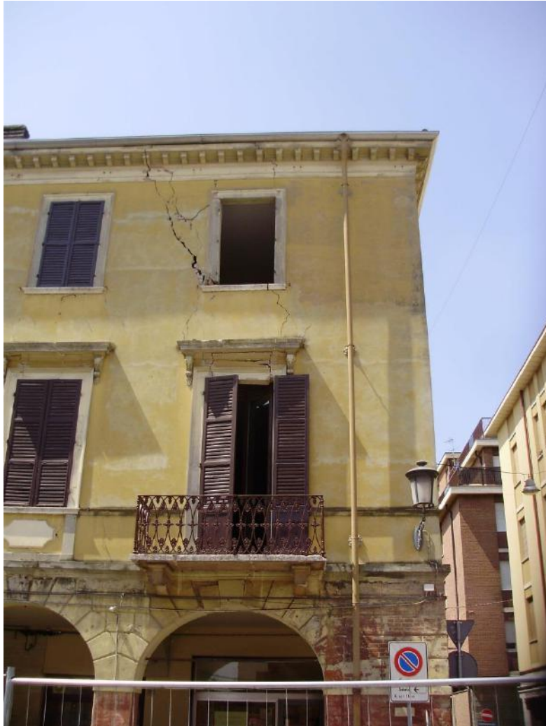
Danno D3/D4 –fessurazione a taglio con possibilità di espulsione del cantonale
