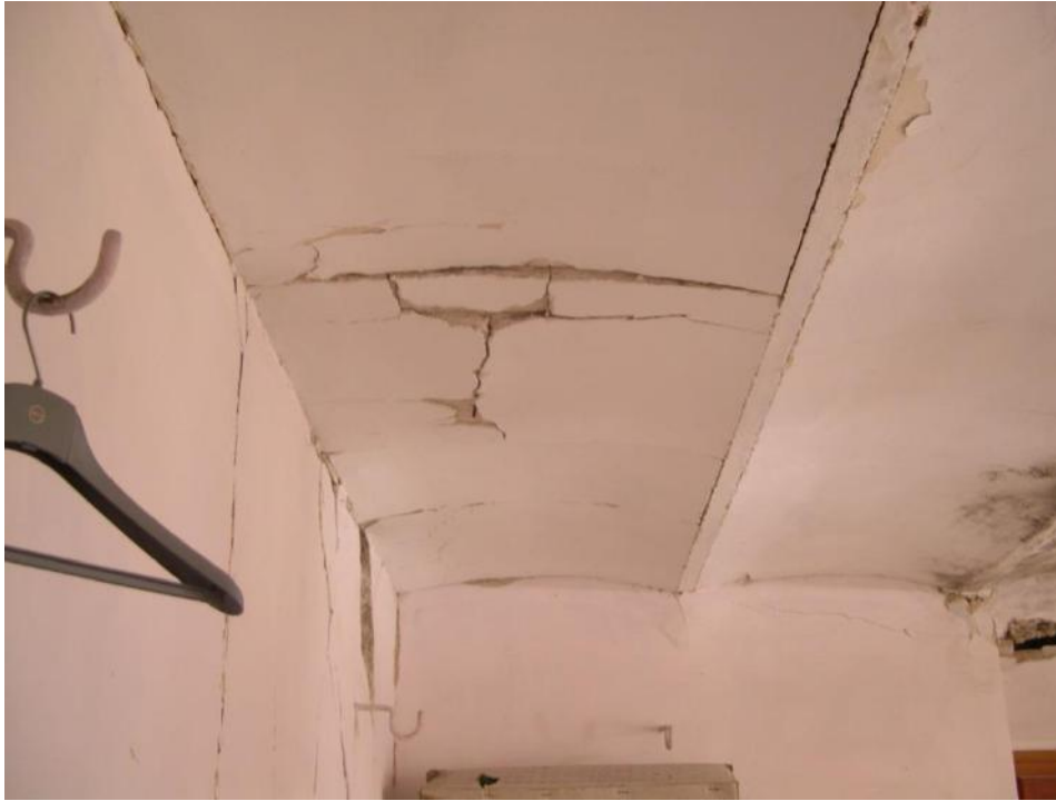
Danno D4/D5-deformazione al limite del crollo di voltina di mattoni in foglio
